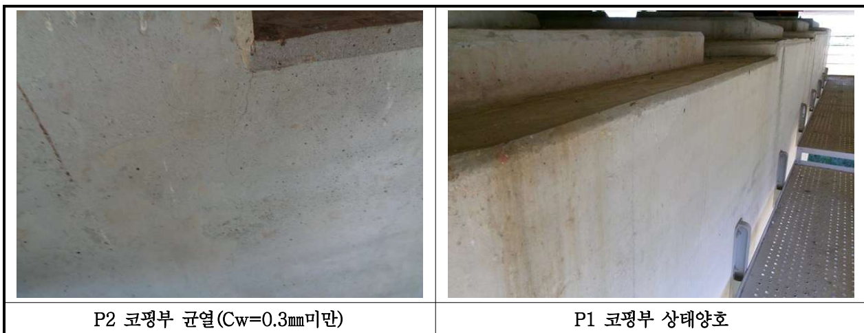
【사진 31.3.11】 교각 손상현황
