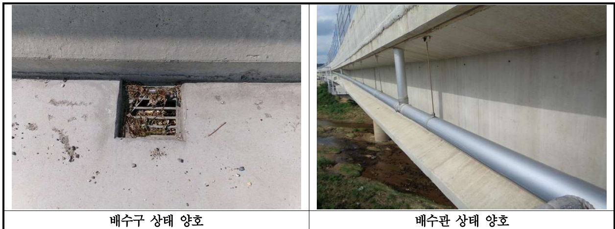
【사진 32.3.22】 배수시설 손상현황
