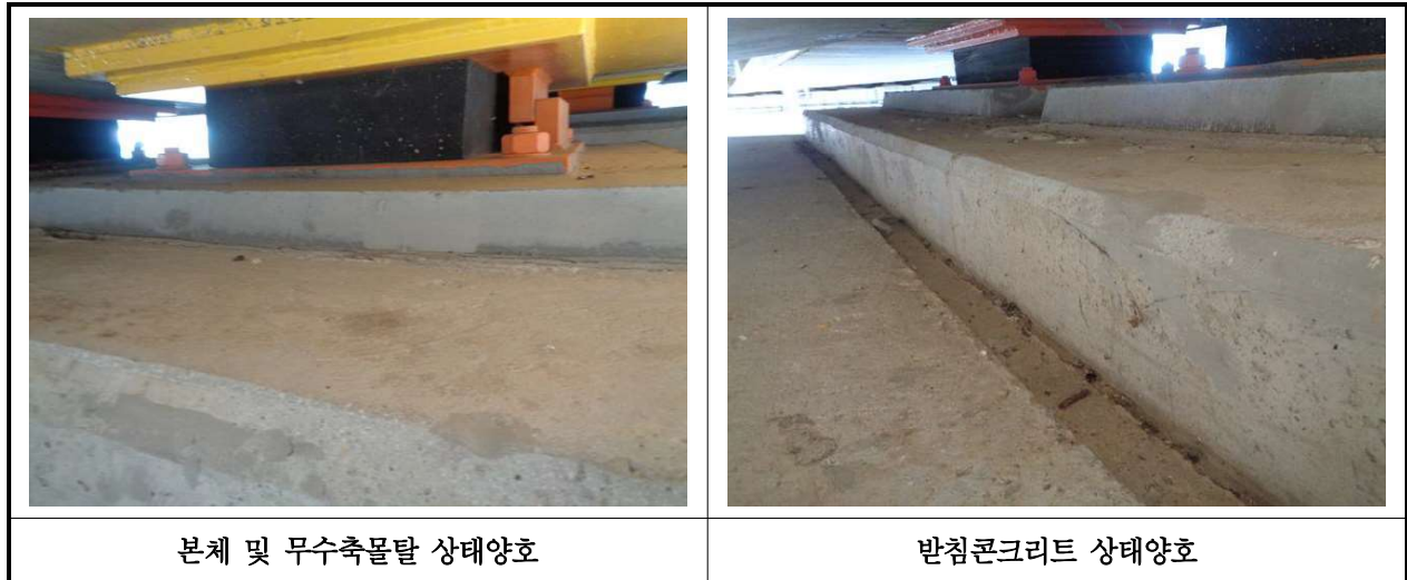
【사진 31.3.13】 교량받침 손상현황
