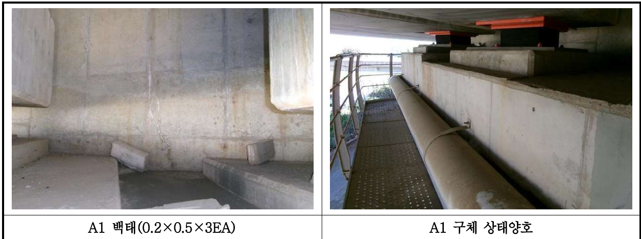
【사진 31.3.9】 교대 손상현황
